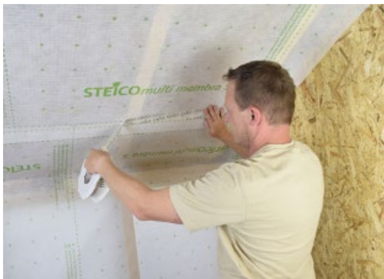
Szczelne połączenie arkuszy membrany STEICOMulti membra 5 przy użyciu taśmy STEICOMulti tape P 60 mm. Fot. STEICO
